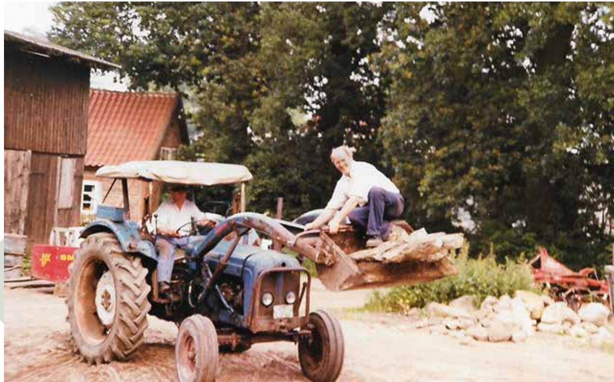
Vorbereitende Arbeiten zum Bau des neuen Kuhstalls 1976/77 – Jürgen Bauck auf der Frontladerschaufel.
